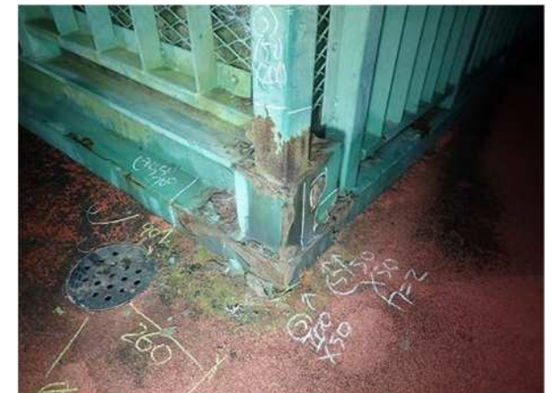
通路部の腐食状況
