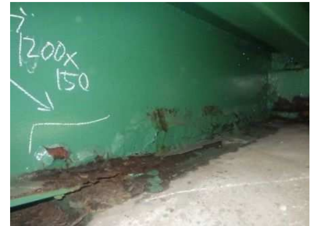
主桁の腐食状況
