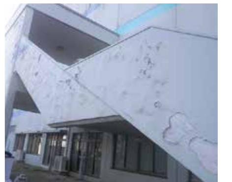
外壁の老朽化が進んでいた中央公民館
