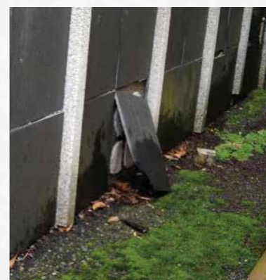
タイルが剥がれ落ちた壁
