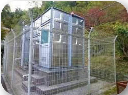
<ヤクルト団地ポンプ室>
