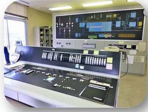
南原浄水場 運転制御室
