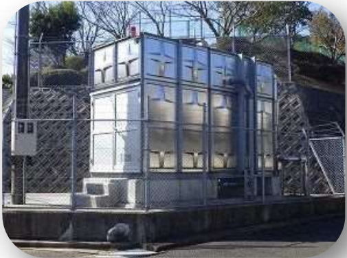
<今古賀加圧ポンプ室>
