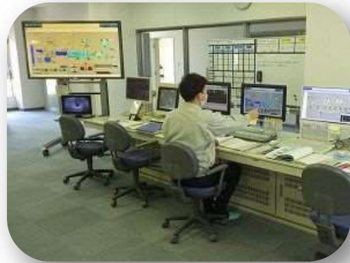
二崎浄水場 運転制御室
