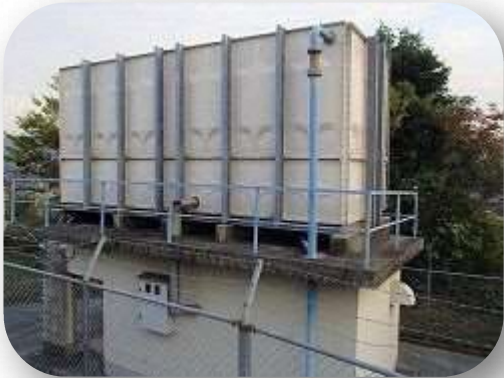
<楠木坂団地ポンプ室>
