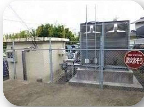
<丸山団地ポンプ室>
