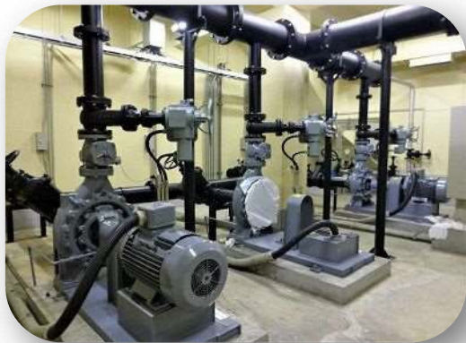
南原浄水場ポンプ室
