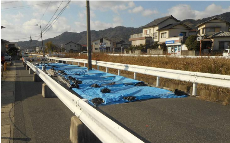
尾倉3丁目の道路陥没現場
