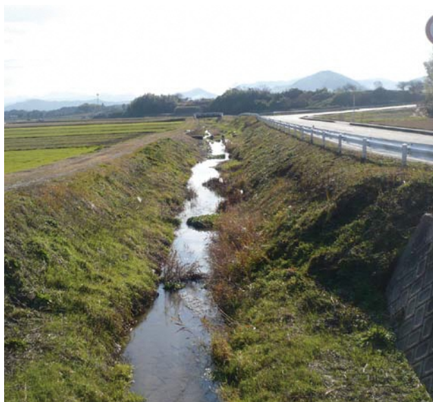
土砂が堆積した白川
