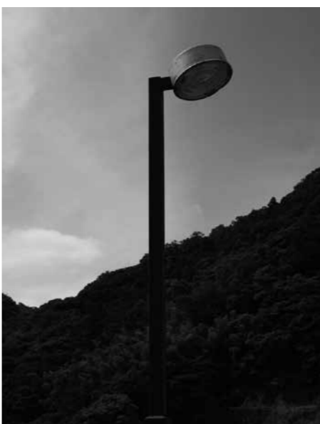
殿川ダム照明灯
