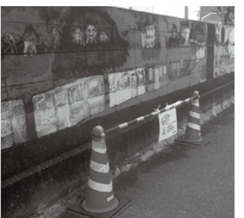
南原小学校の危険ブロック
