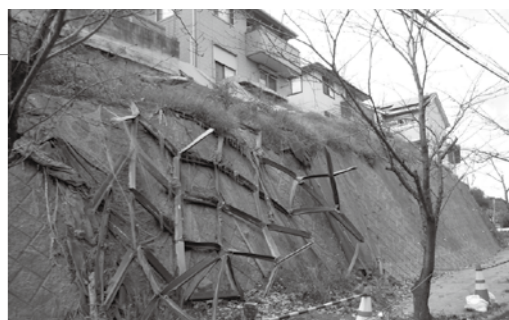
美波台法面崩落現場
