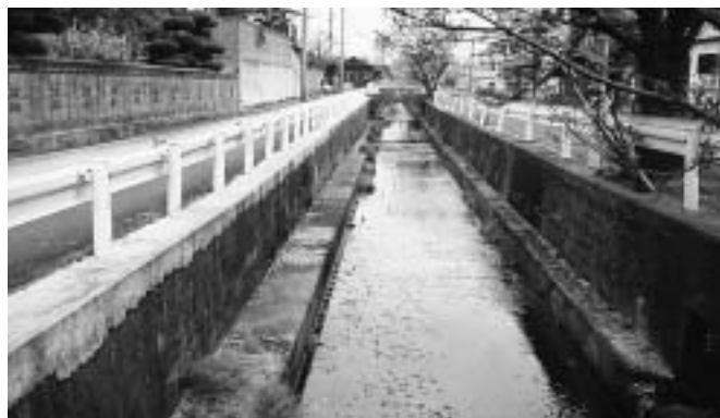
改善が望まれる三面コンクリート河川（玉川）
