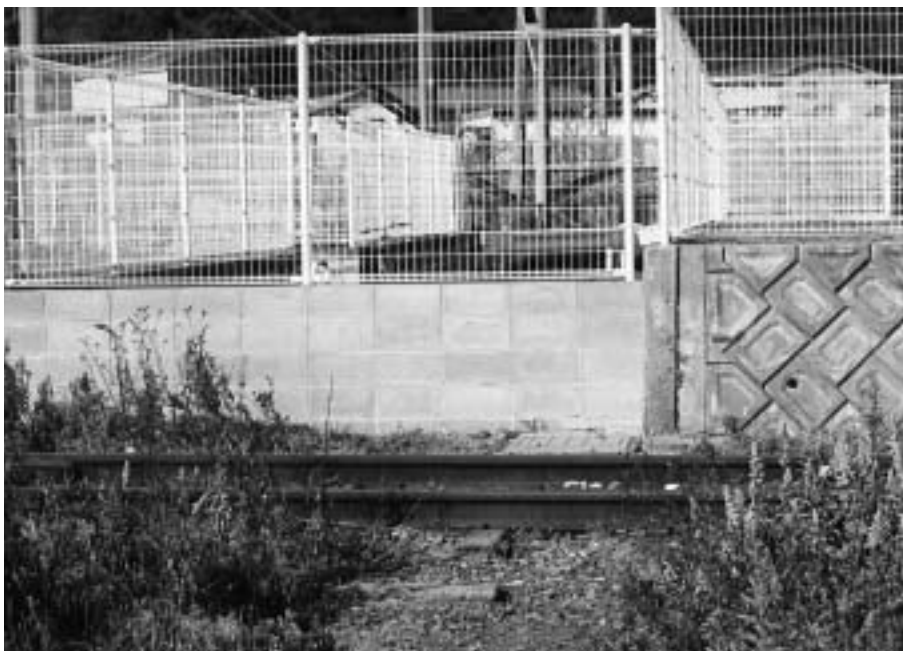
改善が望まれる踏み切り
