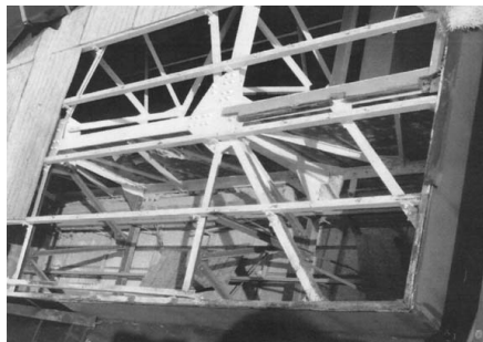
台風被害状況
