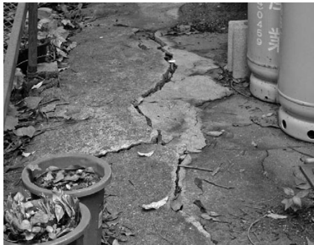
クラックが入った西桜ヶ丘団地
