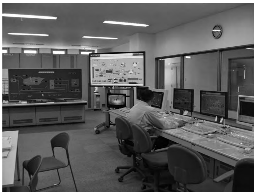
二崎浄水場 制御室
