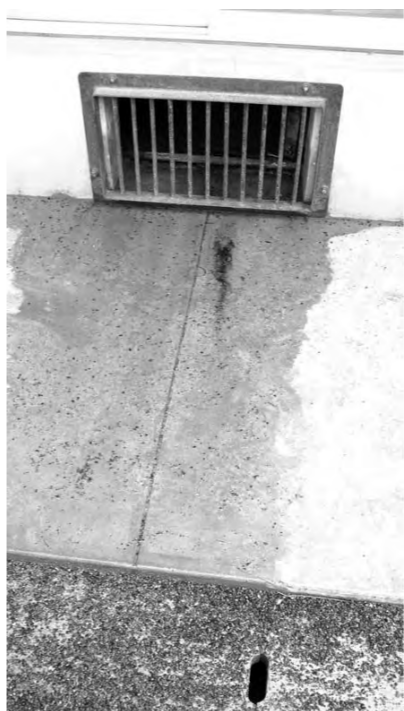
体育館床下部からの湧水
