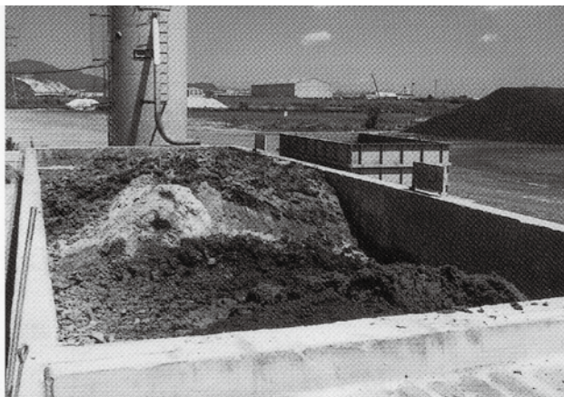
建設汚泥固化設備
