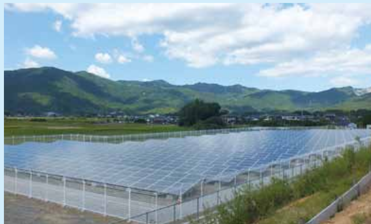
片島・岡崎メガソーラー発電所
