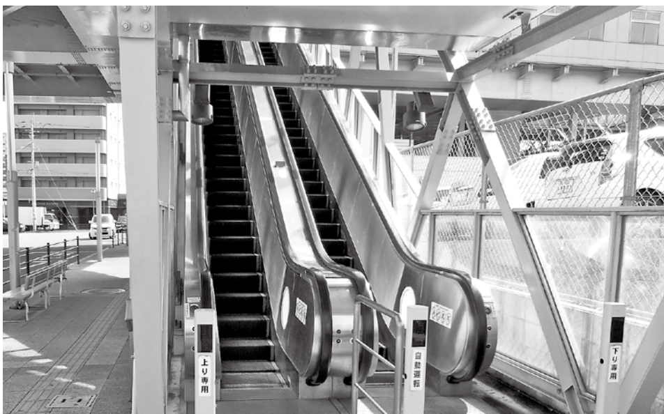
荻田駅エスカレーター
