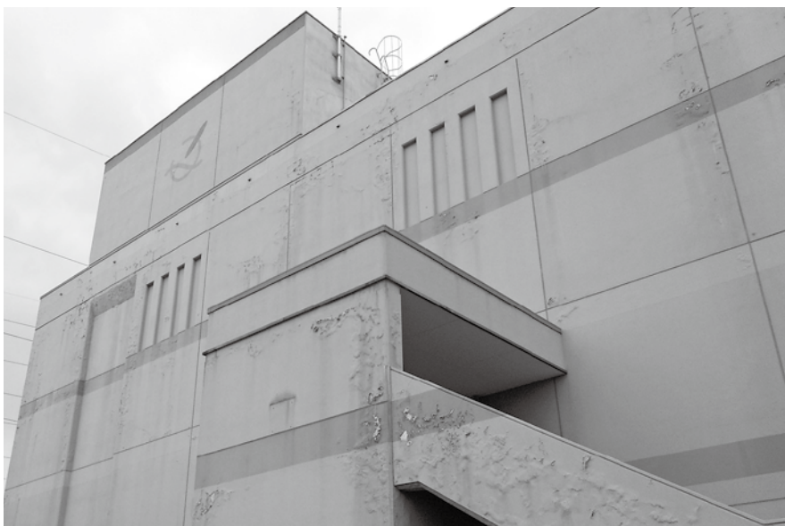
老朽化した公共施設
