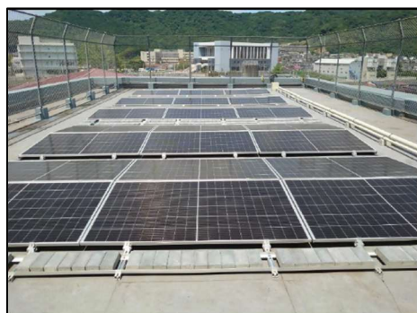
太陽光発電設備 (新津中学校)
