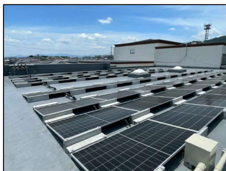
太陽光発電設備 (総合福祉会館)
