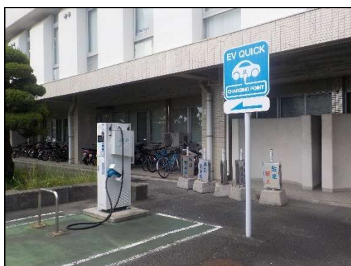
電気自動車充電設備（役場庁舎）
