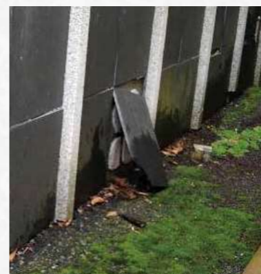
タイルが剥がれ落ちた壁
